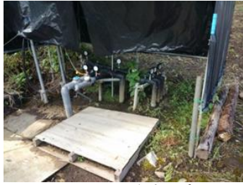
地下水くみ上げポンプ小屋
